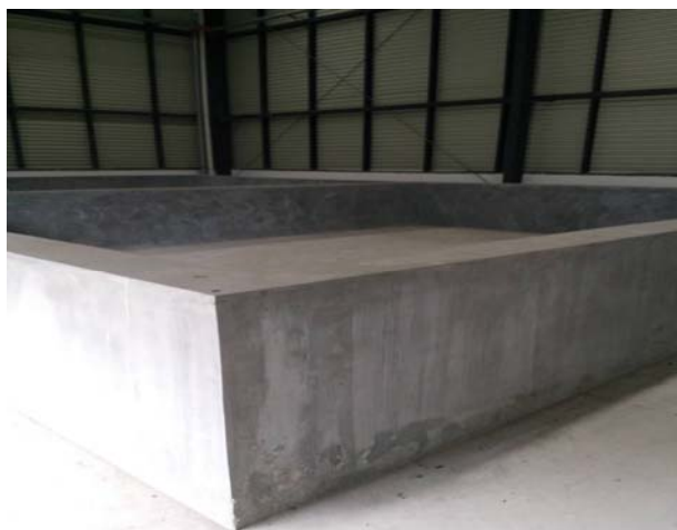
乙醇库房围堰（乙醇目前不储存）
